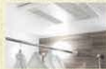
浴室暖房乾燥機
